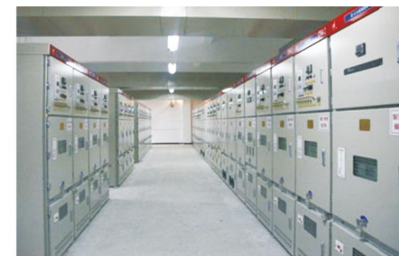
▲ 天津文化中心变电站 Tianjin Cultural Centre Substation
