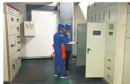
▲ 武警指挥学院变电站 Armed Police Command College Substation
